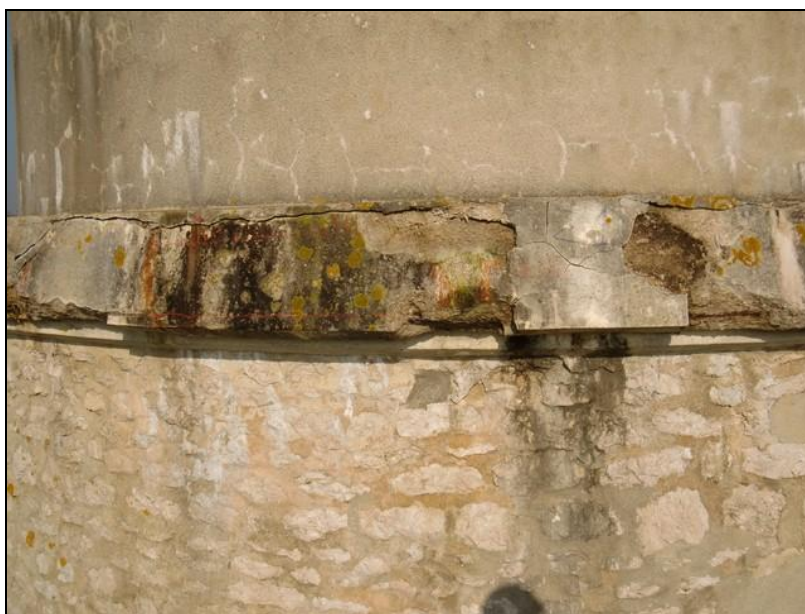
Photo 38 - Eclat et fissuration sur la ceinture basse
