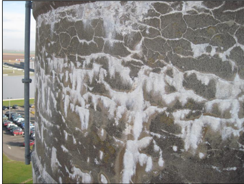
Photo 30 - Fissures et efflorescences sur la cuve
