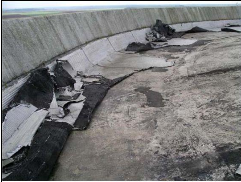
Photo 39 - Décollement de la feuille d'étanchéité
