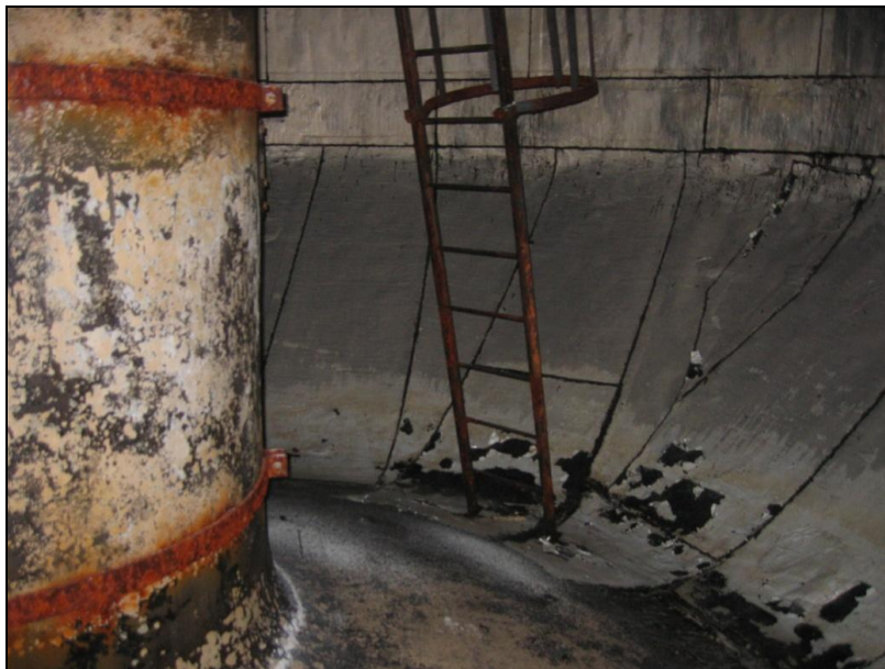
Photo 43 - Décollement d'une étanchéité de type membrane bitumineuse
