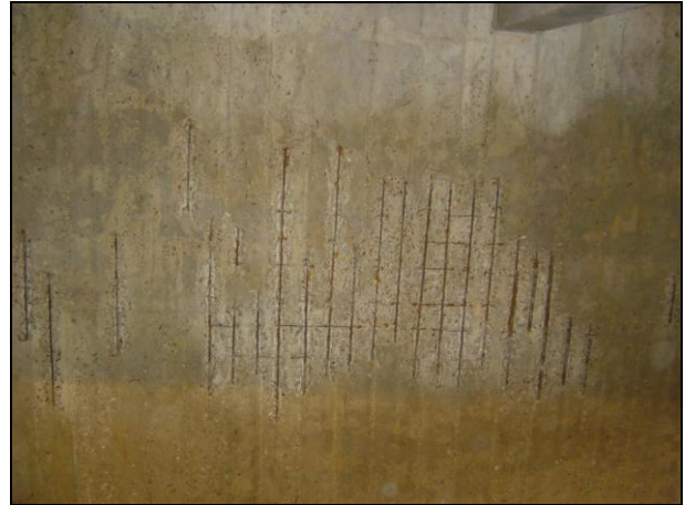
Photo 28 - Aciers corrodés en sous-face de cuve
