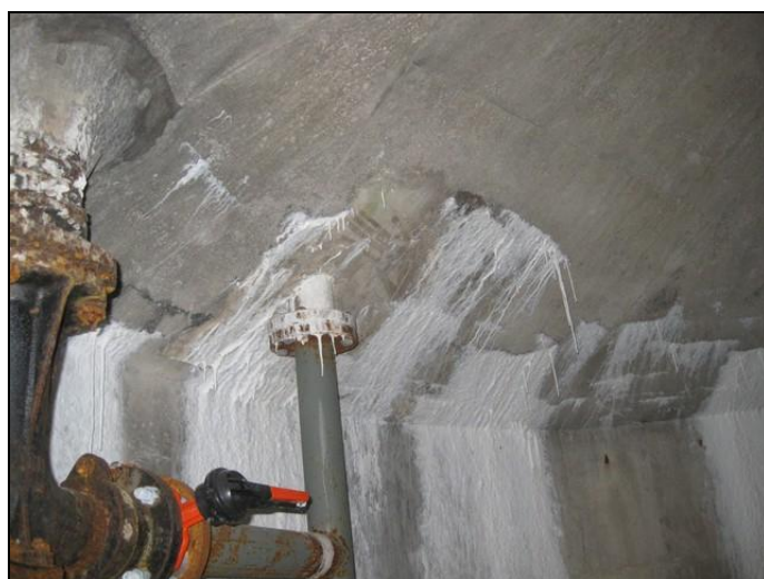
Photo 37 - Efflorescences en sous-face de cuve
