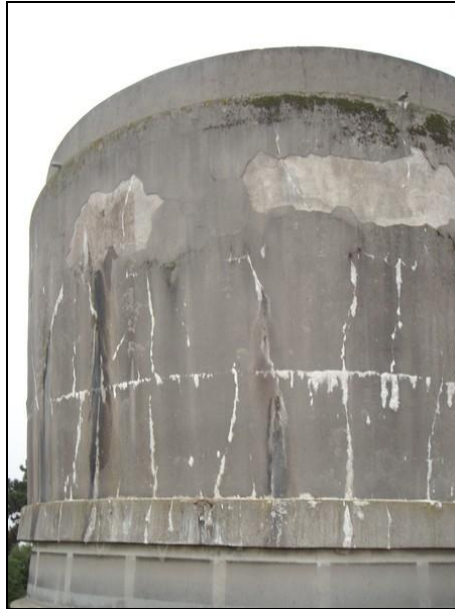
Photo 33 - Fissures verticales et horizontales
