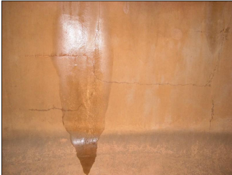
Photo 42 - Fissuration d'une étanchéité de type enduit hydraulique
