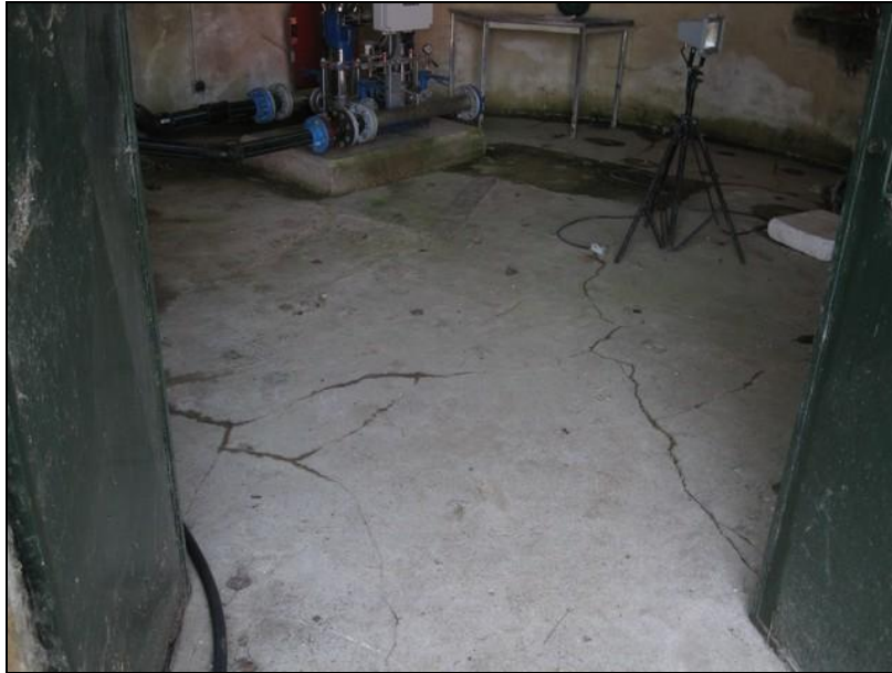
Photo 29 - Fissuration de la dalle du plancher bas du fût, due à des remontées d'eau du sol
