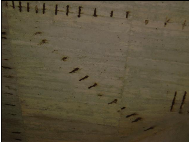
Photo 27 - Aciers corrodés en sous-face de cuve
