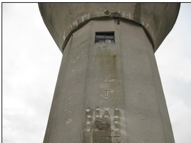
Photo 24 - Aciers apparents et corrodés sur fût
