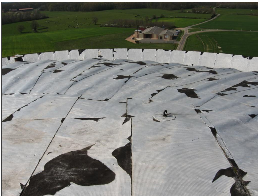
Photo 40 - Décollement partiel de la feuille d'étanchéité
