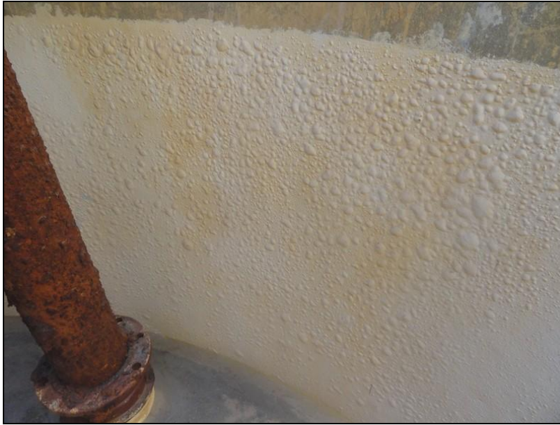
Photo 41 - Cloquage d'une étanchéité polyuréthane
