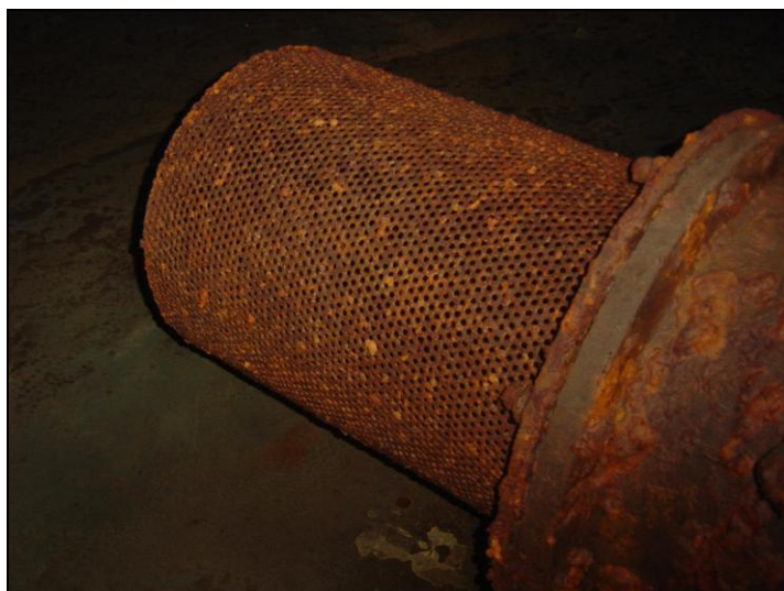
Photo 45 - Corrosion de la crépine de distribution
