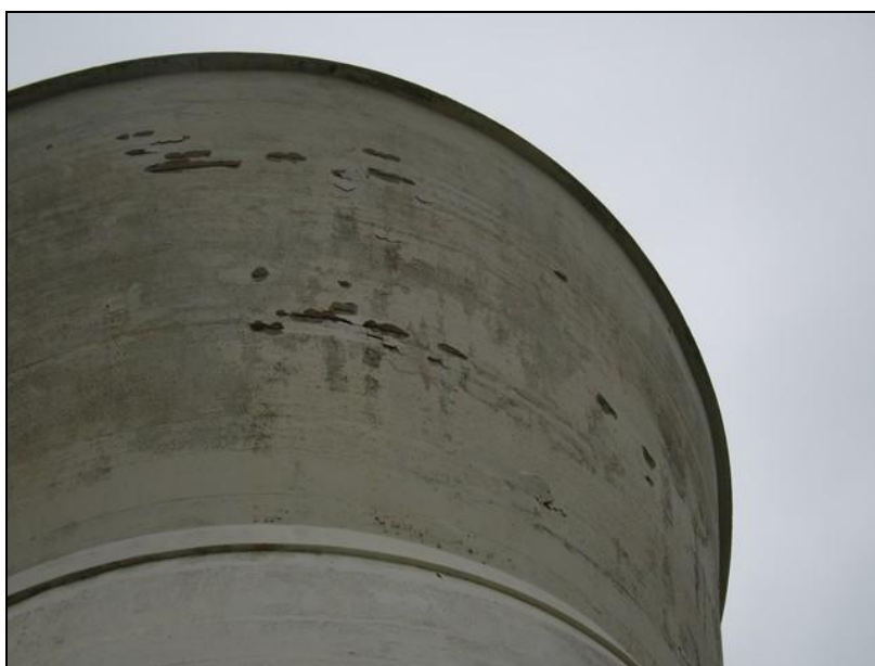
Photo 26 - Aciers apparents et corrodés sur cuve
