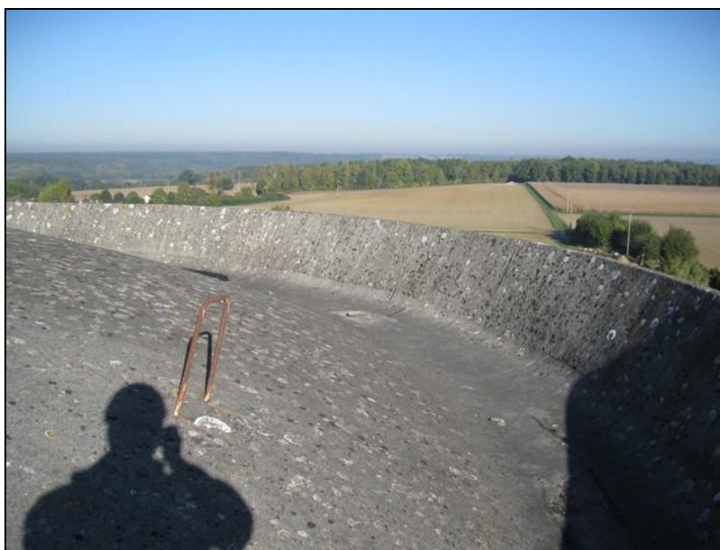
Photo 46 - Absence de garde-corps sur la toiture
