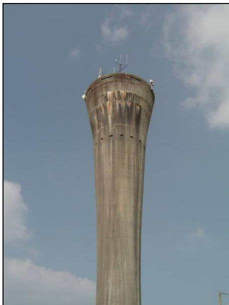
Photo 36 - Suintements et efflorescences sur la cuve
