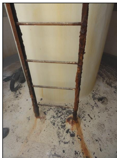
Photo 44 - Corrosion de l'échelle intérieure
