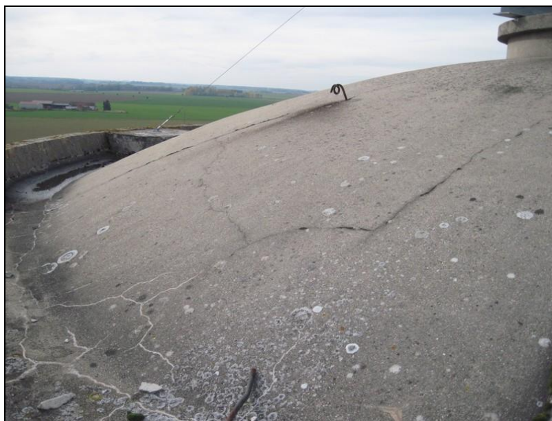
Photo 35 -Fissuration de l'enduit sur coupole
