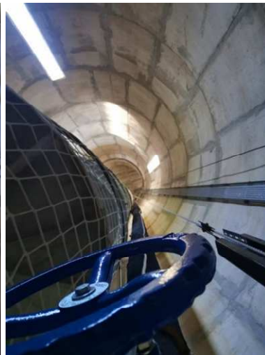
Vanne du 1er étage
