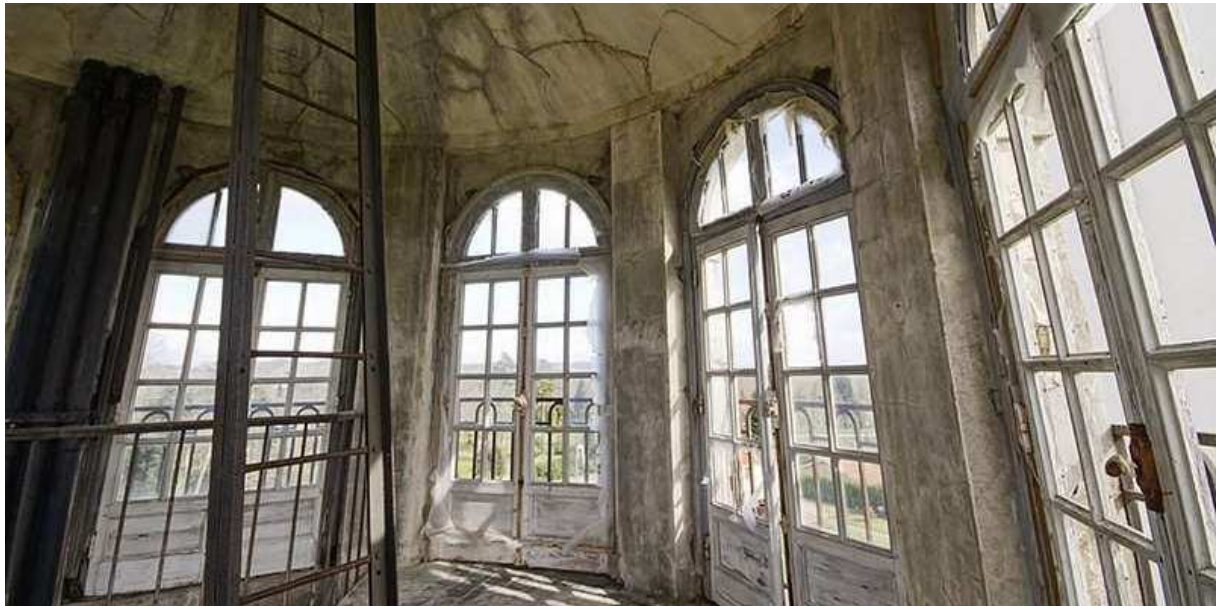
Sous la cuve du château d'eau, la gloriette et sa vue à 360° sur le vignoble des Graves et la vallée de la Garonne. © Crédit photo : Le Groupe des cinq
